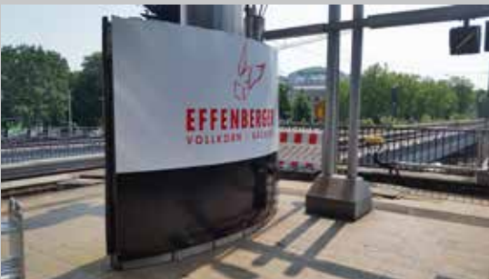
Ummantelung einer Abluft
